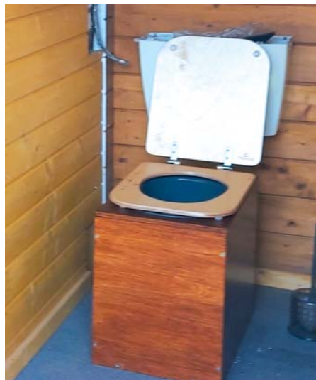
Der Spülkasten hat dank Trenntoilette ausgedient. Foto: Susann Lindner
